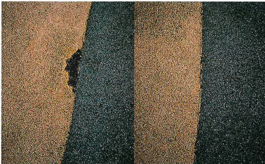
1. Wytarcia nawierzchni na łączeniach kolorów
