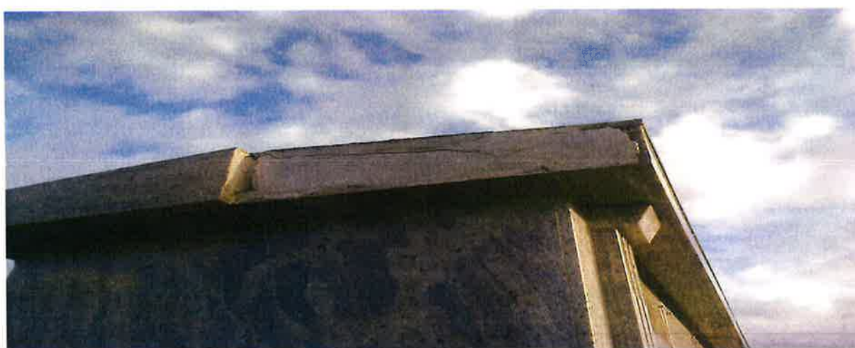
Fot.3,4,5. Brakujące elementy ścian kolumbarium.
