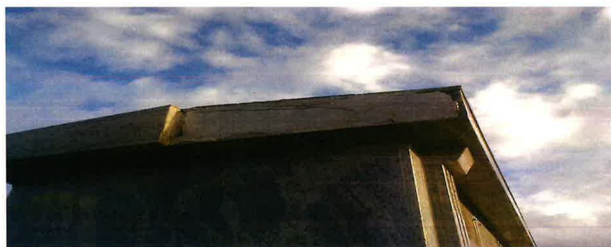
Fot.3,4,5. Brakujące elementy ścian kolumbarium.
