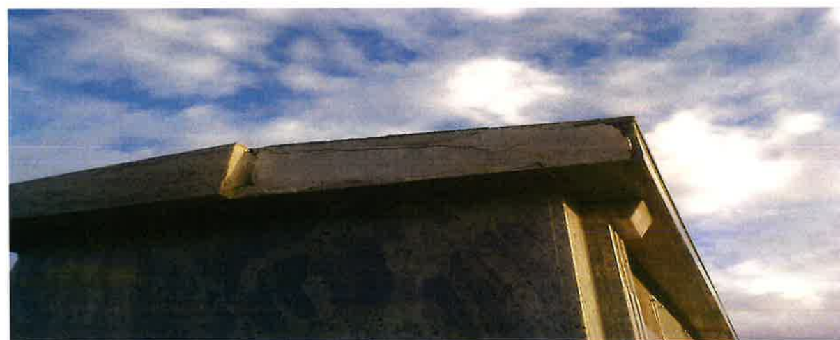
Fot.3,4,5. Brakujące elementy ścian kolumbarium.
