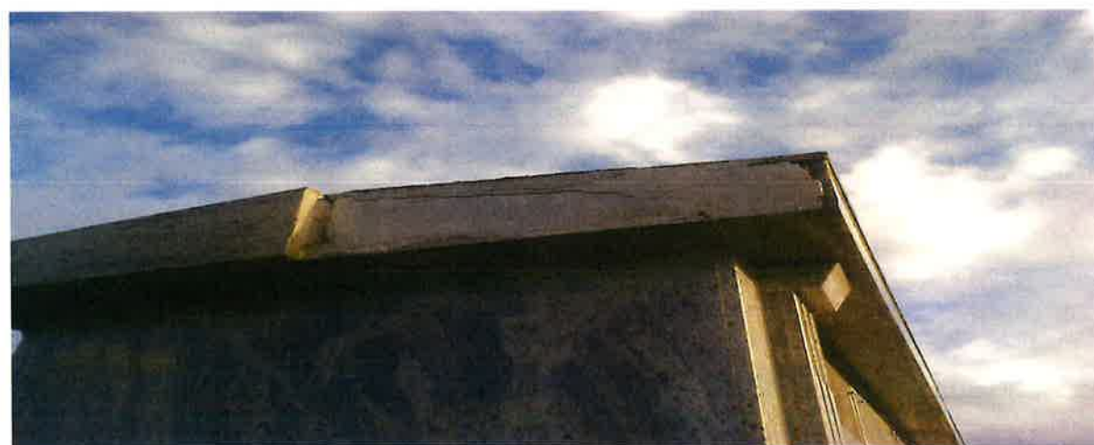
Fot.3,4,5. Brakujące elementy ścian kolumbarium.
