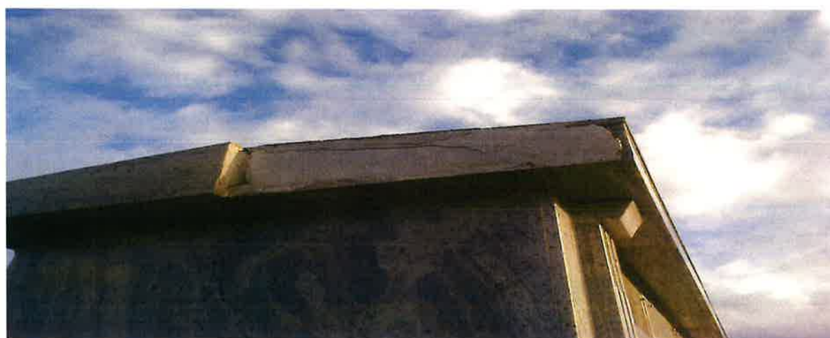
Fot.3,4,5. Brakujące elementy ścian kolumbarium.
