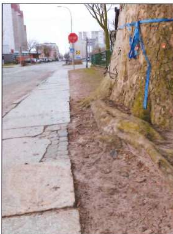
Zdj. 8. Uszkodzenia chodnika powodowane przez system korzeniowy
