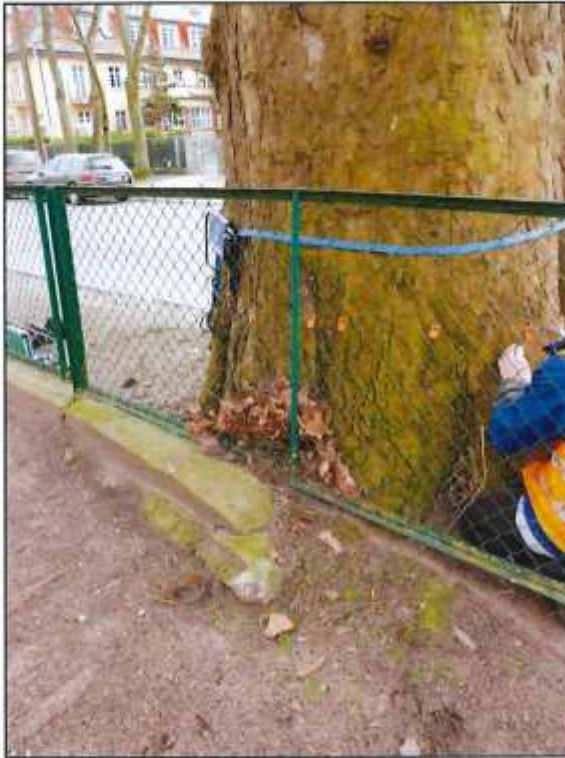
Zdj. 9. Uszkodzenie ogrodzenia przez nabiegi korzeniowe
