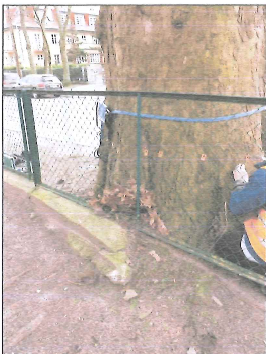
Zdj. 9. Uszkodzenie ogrodzenia przez nabiegi korzeniowe
