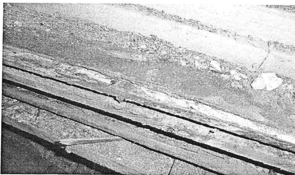
Widok luźnych elementów stropu.
