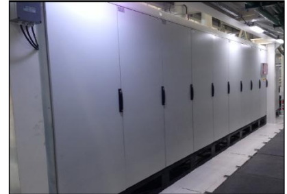
Rys. 2-41 Szafa rozdzielcza mocy
