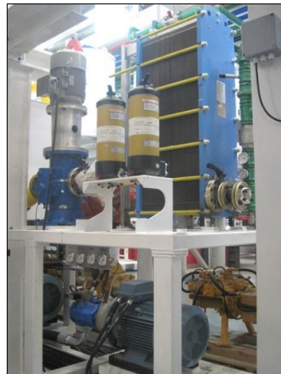
Rys. 2-39 Pompownia do chłodzenia oleju
