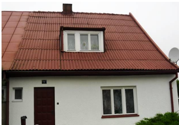
Rys. 6. Pokrycie dachowe ocenione w III stopniu pilności.
