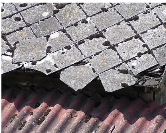
Rys. 8. Pokrycie dachowe ocenione w I stopniu pilności.
