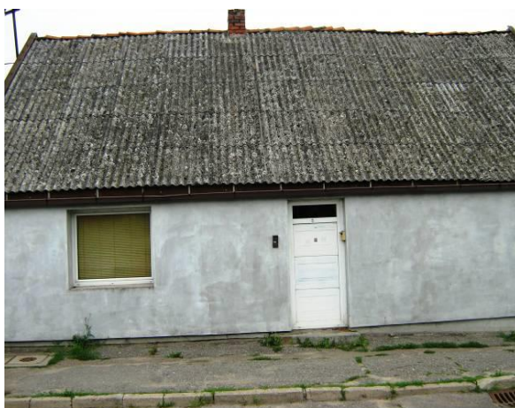
Rys. 7. Pokrycie dachowe ocenione w II stopniu pilności.
