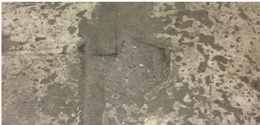
Fot 4. Ubytek w posadzce kotłowni
