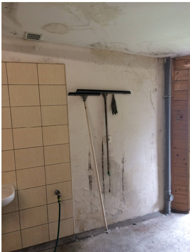
Fot 2. Widok ściany do naprawy
