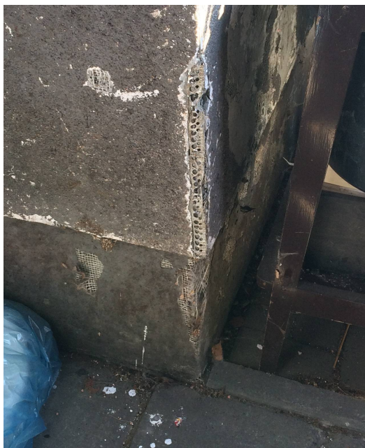
Fot 5. Uszkodzony narożnik
