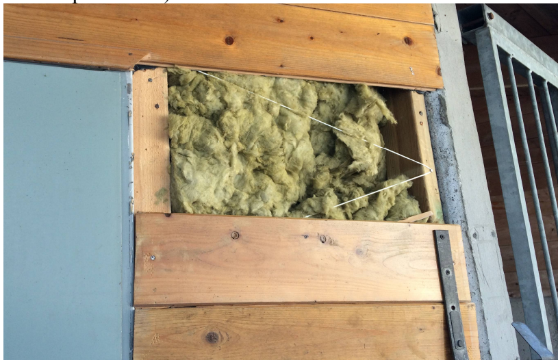
Fot 6. Brakująca deska elewacyjna
