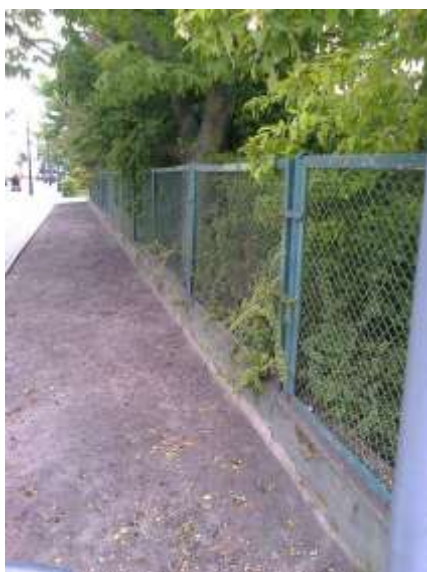
Fot. 7. Odcinek do demontażu i wymiany.
