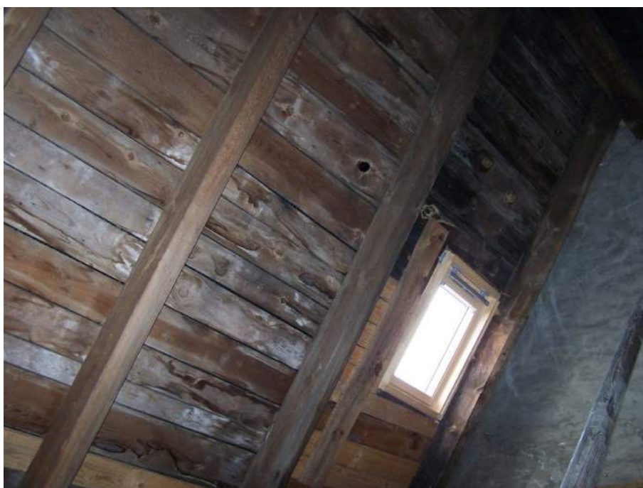
Fotografia nr 6 - Fotografia przedstawia północną część połaci dachu od strony ul. Gabriela Narutowicza. Jest to część niższa dachu, tuż przed ścianą ogniową odgradzającą od części wysokiej. Na deskowaniu połaci dachu widoczne są ślady zacieków, w miejscach tych występują brunatne przebarwienia wywołane przez grzyby domowe Serpula Lacrymans . Na deskowaniu widoczny jest biały, powierzchniowy nalot wywołany przez grzyby domowe Serpula Lacrymans .
