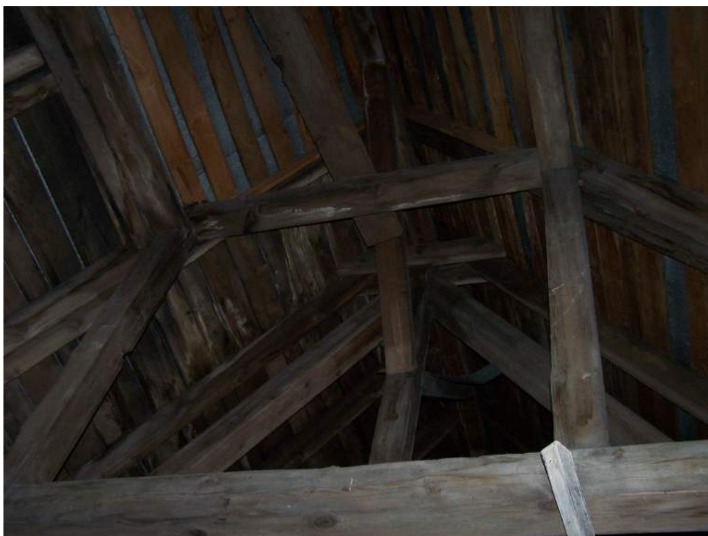
Fotografia nr 22 – Deskowanie i belki konstrukcyjne w górnej części zachodniej połaci dachu są silnie zagrzybione. Zagrzybienie wywołane jest przez grzyby domowe Serpula Lacrymans .
