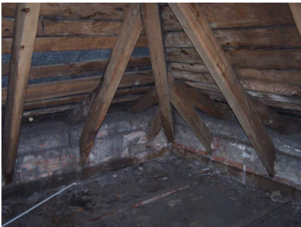
Fotografia nr 16 – Wysoka część dachu nad południową klatką schodową. Na fotografii widoczne jest deskowanie porażone przez grzyby domowe Serpula Lacrymans .
