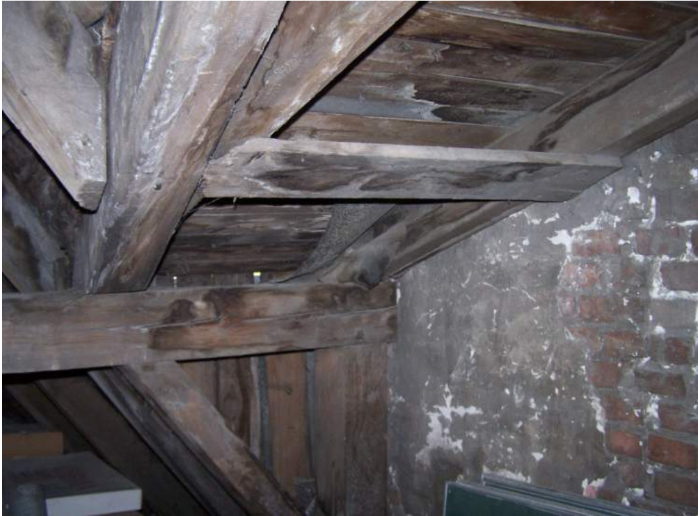
Fotografia nr 17 – Strych równoległy do ul. Mar. Józefa Piłsudskiego. Na fotografii widoczne jest zagrzybienie belki koszowej w północnozachodniej części.
