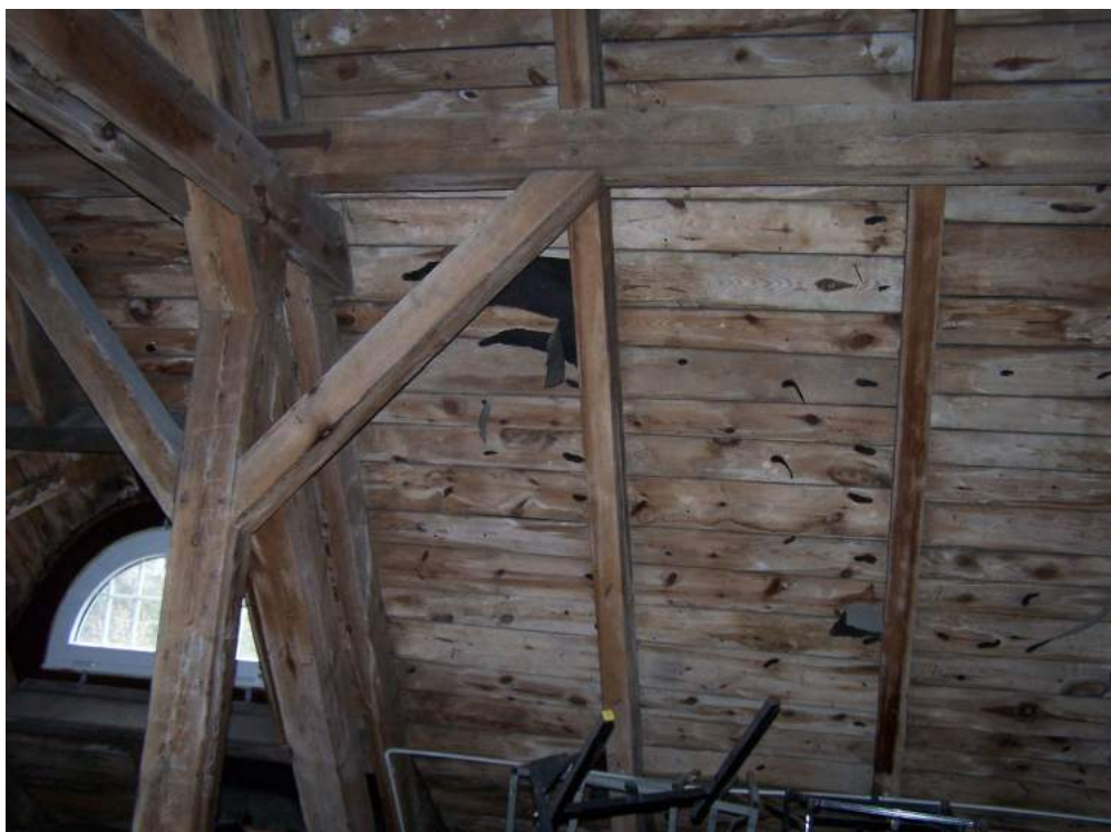
Fotografia nr 3 – Północno zachodni narożnik od strony ul. Gabriela Narutowicza porażony przez grzyby domowe Serpula Lacrymans . Biały nalot na deskach i elementach konstrukcyjnych wywołany jest przez grzyby.
