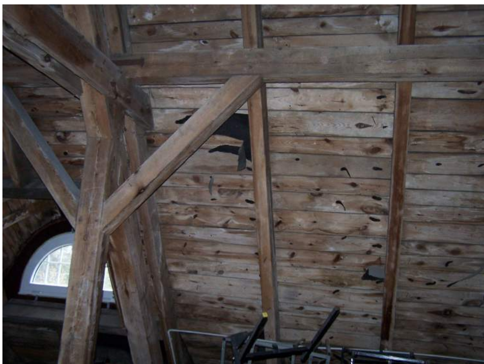
Fotografia nr 4 - Południowo zachodni narożnik od strony ul. Fryderyka Chopina porażony jest przez grzyby domowe Serpula Lacrymans . Drewniane elementy więźby dachowej i deskowanie pokryte są białym nalotem wywołanym przez grzyby.
