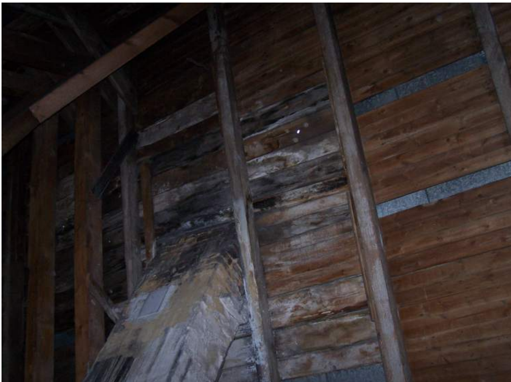
Fotografia nr 18 – Strych równoległy do ul. Mar. Józefa Piłsudskiego. Na fotografii widoczne jest silne zagrzybienie wywołane przez grzyby domowe Serpula Lacrymans . Zagrzybienie powstało na skutek nieszczelności wokół komina nr 1.
