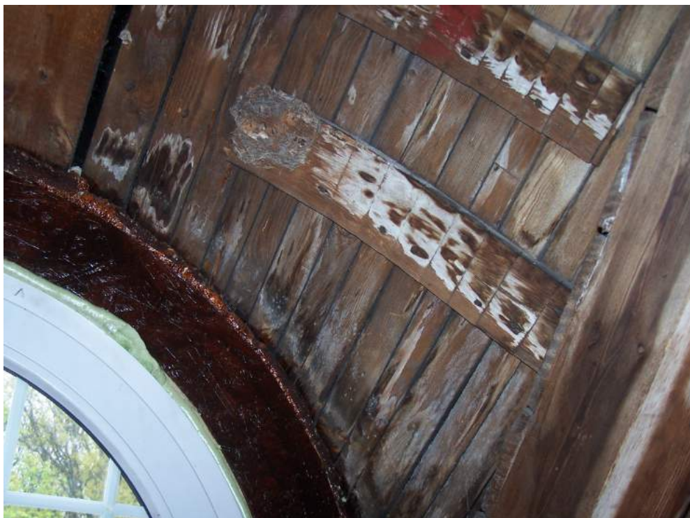
Fotografia nr 1 – Północno zachodnia część więźby dachowej od strony ul. Gabriela Narutowicza. Na fotografii widoczne deskowanie nad oknem bawolim. Deskowanie porażone jest przez grzyby domowe Serpula Lacrymans .
