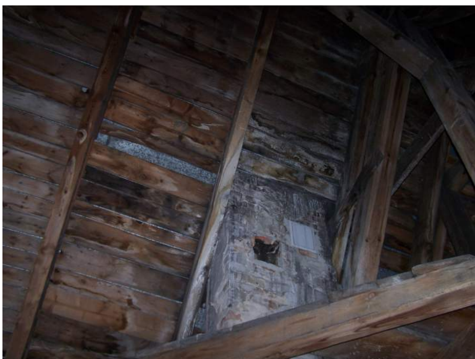
Fotografia nr 20 – Strych równoległy do ul. Mar. Józefa Piłsudskiego. Na fotografii widoczne jest silne zagrzybienie wywołane przez grzyby domowe Serpula Lacrymans . Zagrzybienie powstało na skutek nieszczelności wokół komina nr 3.
