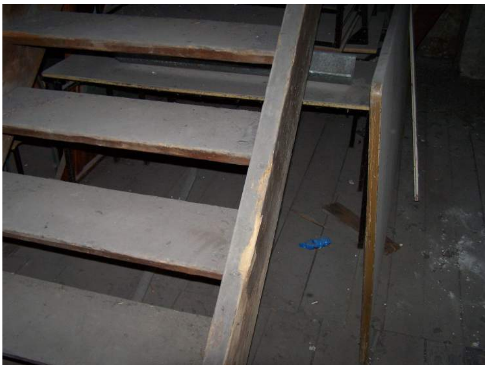
Fotografia nr 7 – Prawy policzek schodów, równoległy do ul. Gabriela Narutowicza jest mocno zaatakowany przez owada kołatka domowego Anobium punctatum . Należy wymienić prawy policzek i słupki balustrad.
