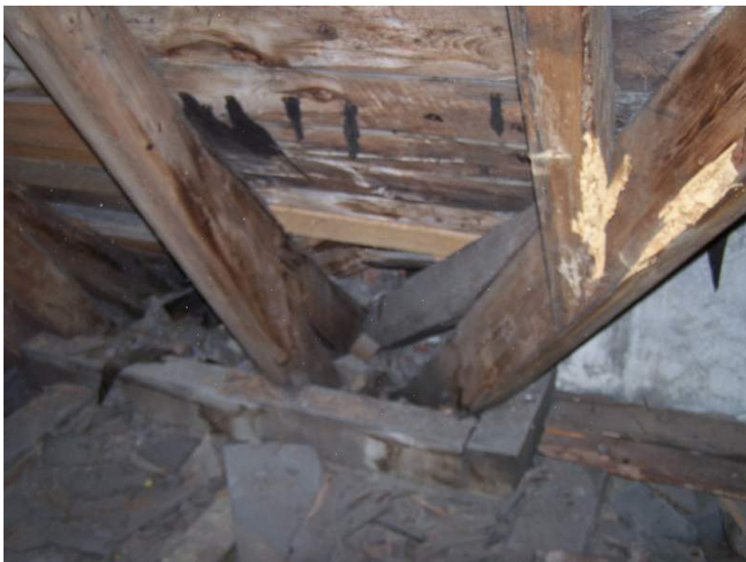
Fotografia nr 15 – Więźba dachowa usztywniona stalową ramą. Południowo wschodnie belki porażone są przez owada spuszczela Hylotrupes bajulus
