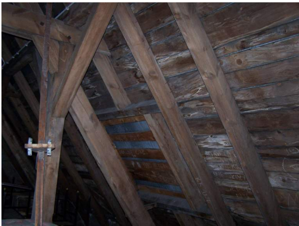
Fotografia nr 21 – Strych równoległy do ul. Mar. Józefa Piłsudskiego. Zagrzybione deskowanie na wschodniej połaci w części środkowej. Zagrzybienie wywołane przez grzyby domowe Serpula Lacrymans .
