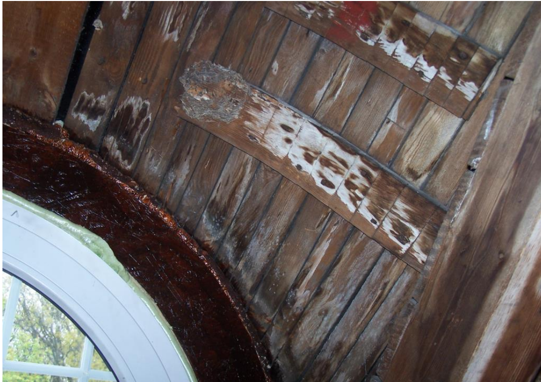
Fotografia nr 1 – Północno zachodnia część więźby dachowej od strony ul. Gabriela Narutowicza. Na fotografii widoczne deskowanie nad oknem bawolim. Deskowanie porażone jest przez grzyby domowe Serpula Lacrymans .
