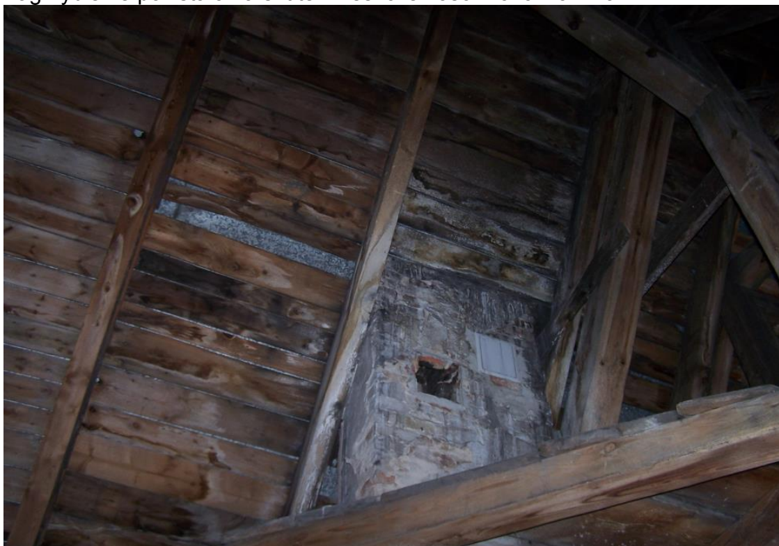
Fotografia nr 20 – Strych równoległy do ul. Mar. Józefa Piłsudskiego. Na fotografii widoczne jest silne zagrzybienie wywołane przez grzyby domowe Serpula Lacrymans . Zagrzybienie powstało na skutek nieszczelności wokół komina nr 3.
