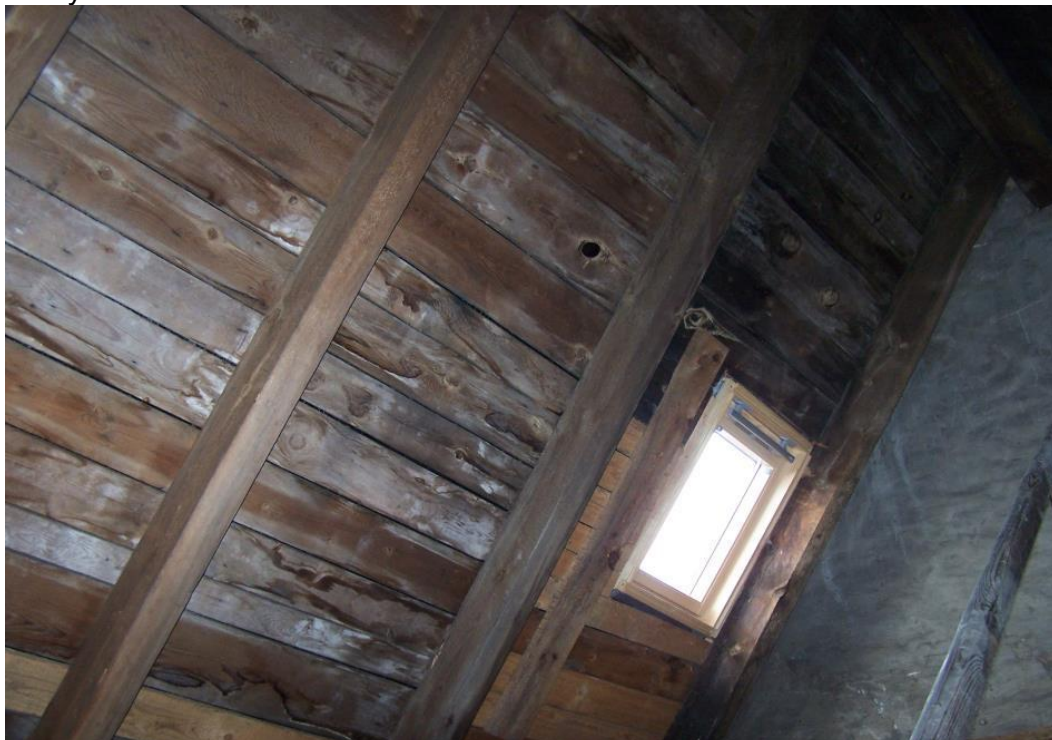
Fotografia nr 6 - Fotografia przedstawia północną część połaci dachu od strony ul. Gabriela Narutowicza. Jest to część niższa dachu, tuż przed ścianą ogniową odgradzającą od części wysokiej. Na deskowaniu połaci dachu widoczne są ślady zacieków, w miejscach tych występują brunatne przebarwienia wywołane przez grzyby domowe Serpula Lacrymans . Na deskowaniu widoczny jest biały, powierzchniowy nalot wywołany przez grzyby domowe Serpula Lacrymans .
