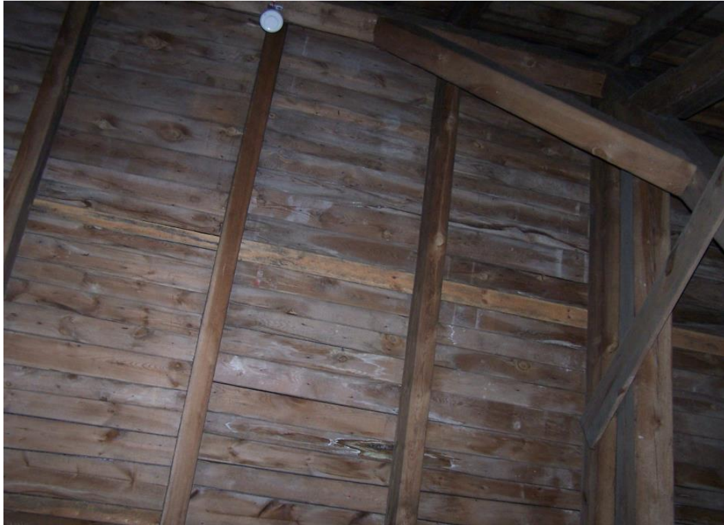
Fotografia nr 5 – Południowa część dachu od strony dziedzińca. Deskowanie pokryte jest powierzchnią warstwą białego nalotu wywołaną przez grzyby domowe Serpula Lacrymans .
