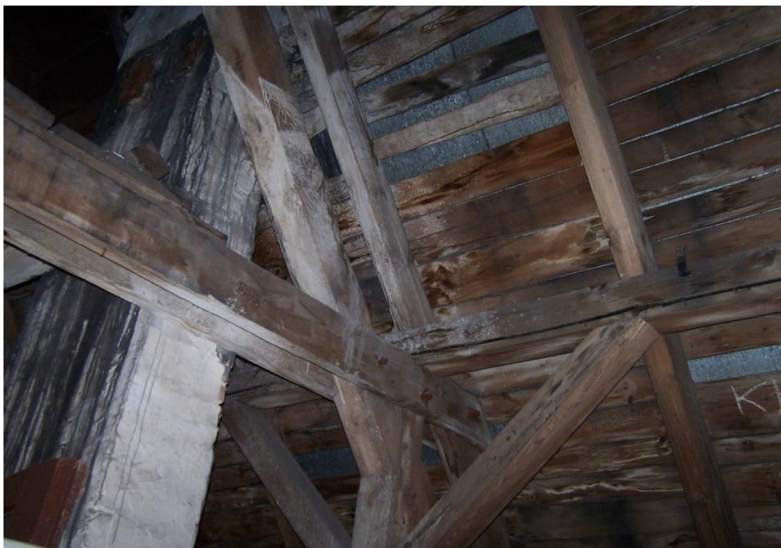
Fotografia nr 19 – Strych równoległy do ul. Mar. Józefa Piłsudskiego. Na fotografii widoczne jest silne zagrzybienie wywołane przez grzyby domowe Serpula Lacrymans . Zagrzybienie powstało na skutek nieszczelności wokół komina nr 2.
