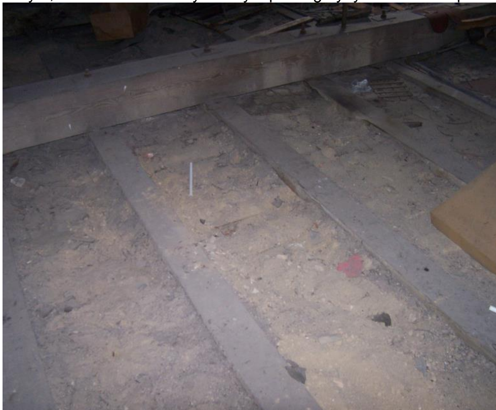
Fotografia nr 12 – Więźba dachowa usztywniona stalową ramą. Fotografia pokazuje polepę piaskową znajdującą się w centralnej części poddasza. Polepa nie jest z wierzchu
