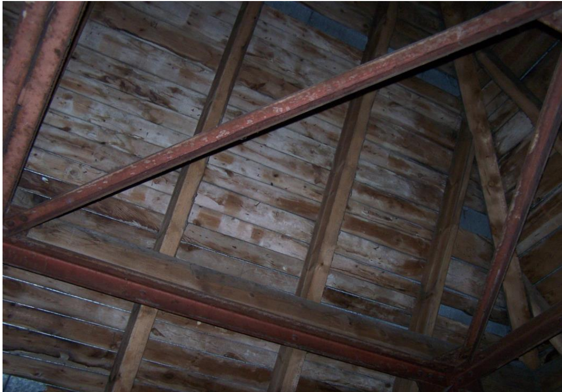
Fotografia nr 11 – Więźba dachowa usztywniona stalową ramą. Fotografia przedstawia widok w kierunku górnej południowej połaci dachu. Deskowanie na tej połaci pokryte jest białym, cienkim nalotem wywołanym przez grzyby domowe Serpula Lacrymans .
