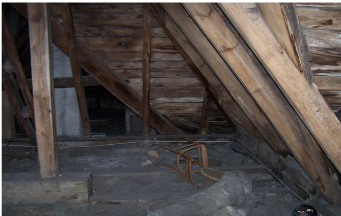
Fotografia nr 9 – Wieżba dachowa usztywniona stalową ramą. Widok w kierunku południowo zachodniego narożnika od strony dziedzińca. Na fotografii widoczna jest belka koszowa i deskowanie, na których widoczne są brunatne przebarwienia świadczące o zaciekach. W chwili obecnej miejsca te porażone są przez grzyby domowe Serpula Lacrymans . Ponadto na deskowaniu widoczny jest biały powierzchniowy nalot wywołany przez grzyby domowe Serpula Lacrymans .
