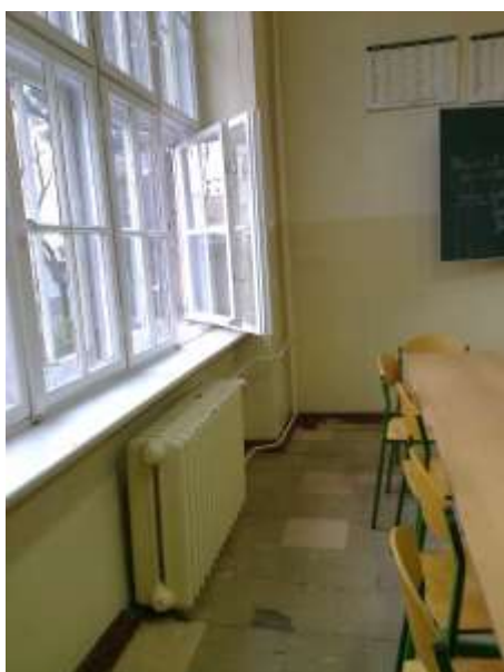
Fot. 2. Podłoga przy grzejniku.
