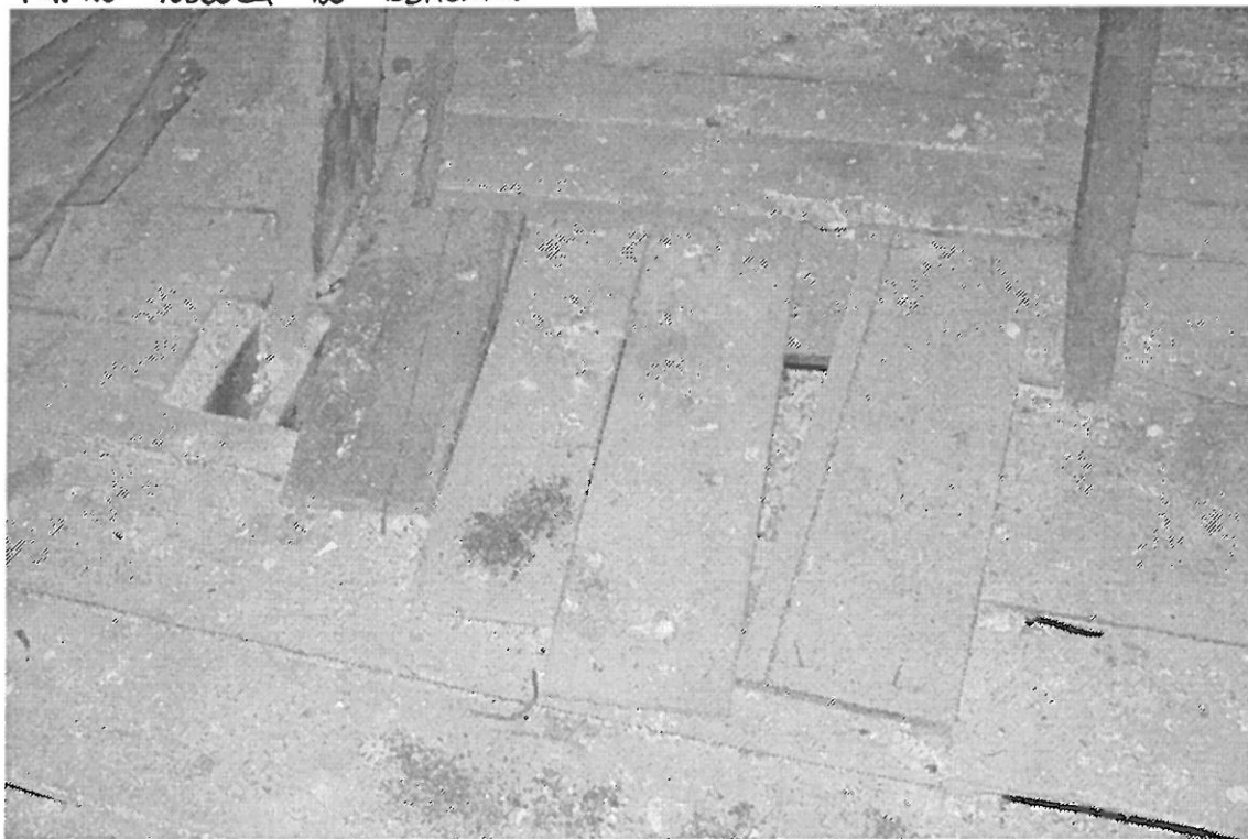
FOT. 10 PODŁOGA POD REMONTU.
