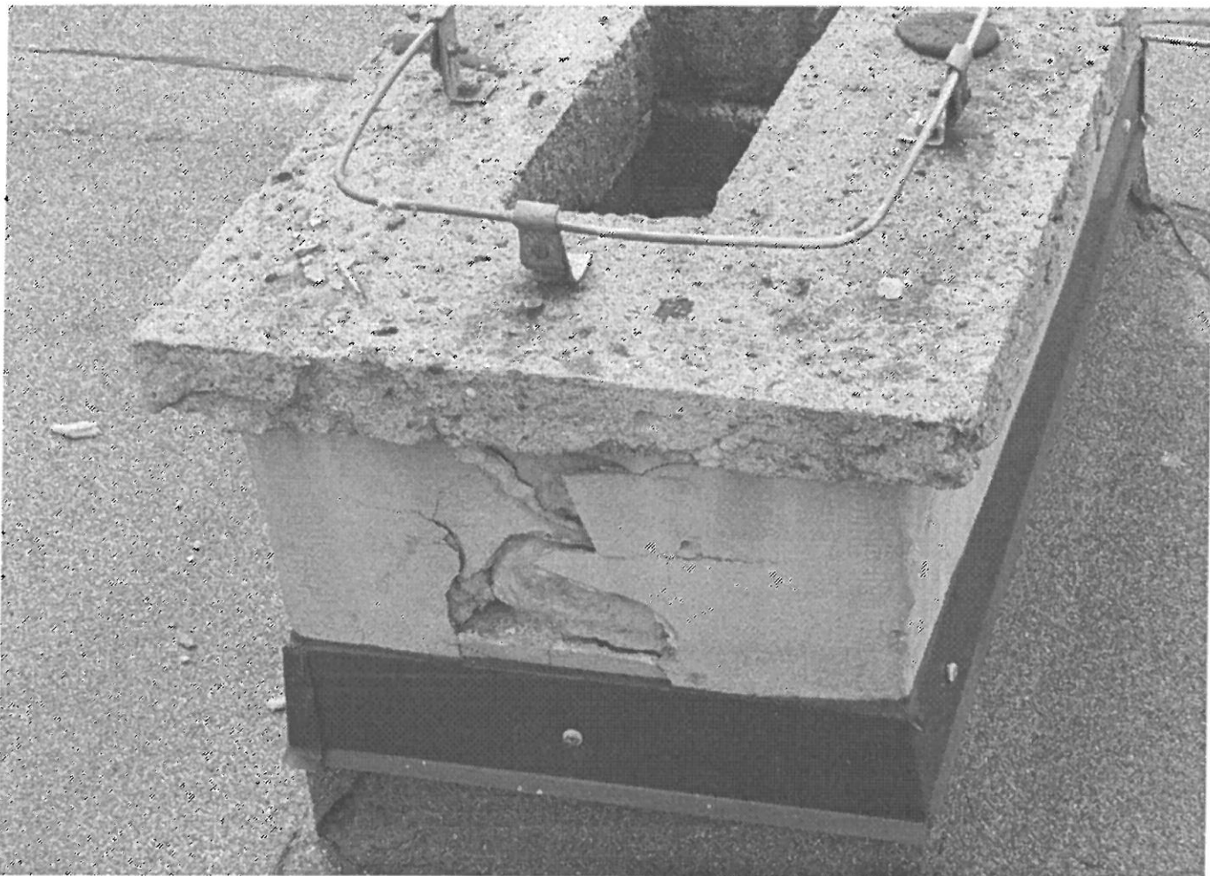
FOT. 3 DACH WĄSOKI, KOMIN LENTYL. DO REMONTU
