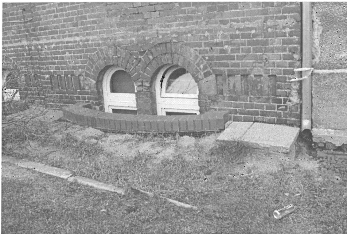
FOT. 3 OKNA PODPILNIENIA.
