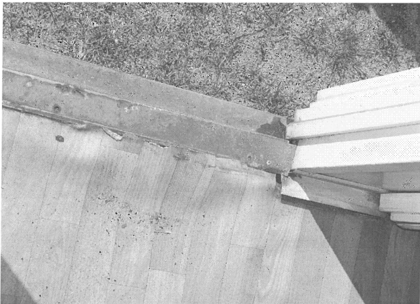
FOT. 5 KONTENER - WIDOK NA PRÓG WEJŚCIOWĄ DO NAPRAWY.
