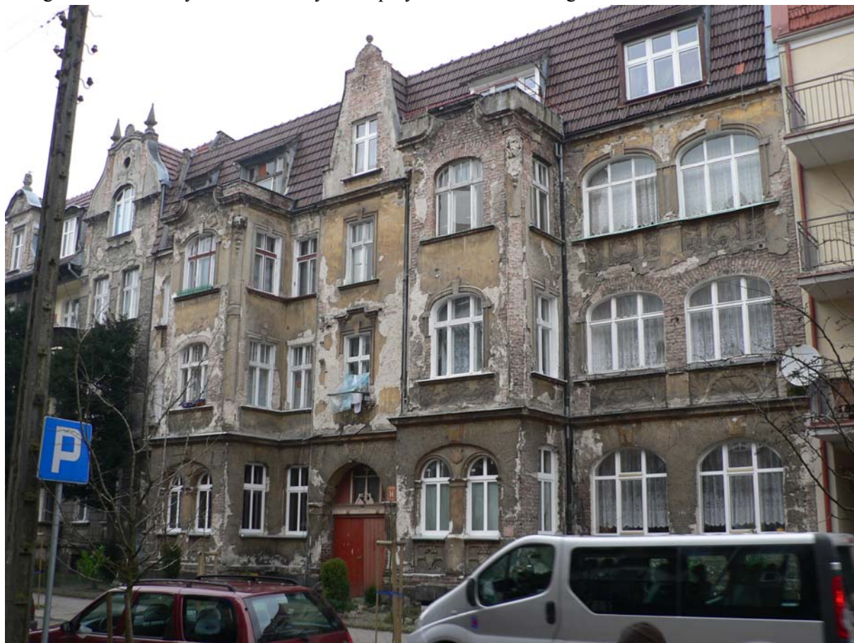
Fotografia nr 11. Budynek mieszkalny nr 14 przy ul. Hołdu Pruskiego.
